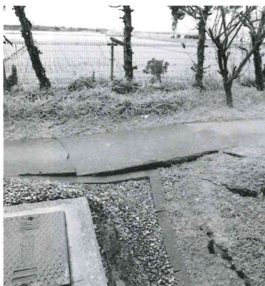
陥没したたんぼぼ小径(現在使用中止)
