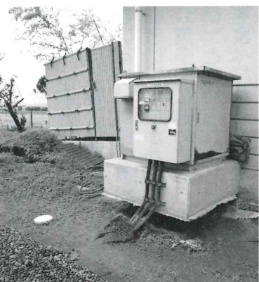
地盤沈下で浮き上がった浄化槽機器
